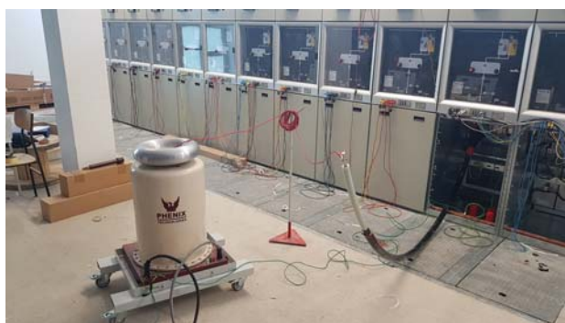
Slika 2. Ispitivanje postrojenja 35 kV izmjeničnim naponom 50 kV u trajanju od 1 min.
