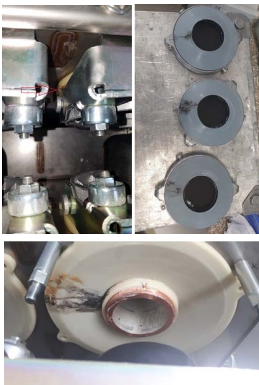
Slika 3. Mjesto proboja i slike oštećenja završnih kapa na polju =H7.1
